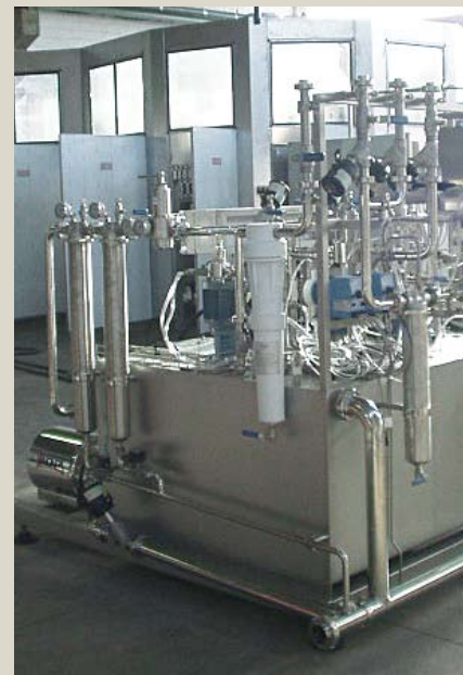
Unità di preparazione cloro
