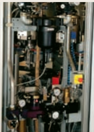
Gli ingressi acqua e aria sono perfettamente accessibili.
