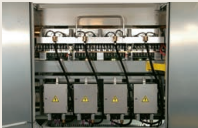
Minori dimensioni dell'armadio principale grazie allo spostamento dei quadri elettrici.
