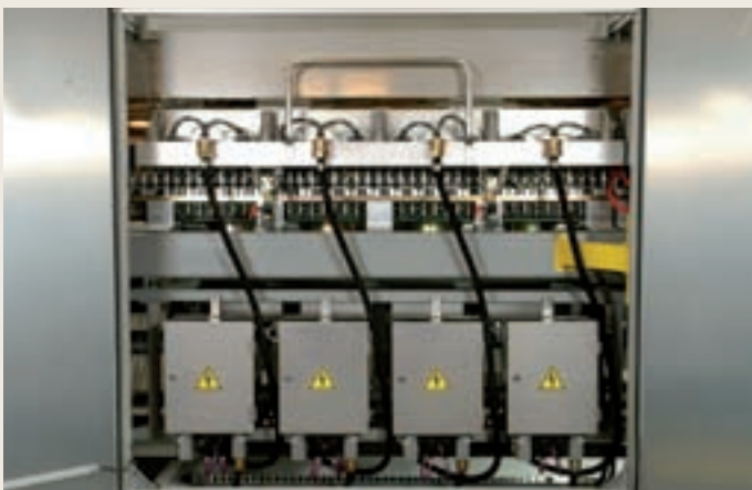
La délocalisation des coffrets électriques réduit la taille de l'armoire principale.
