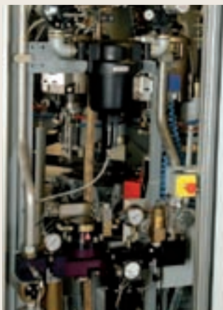
Les arrivées eau et air sont parfaitement accessibles.
