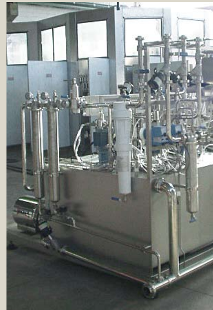
Unité de préparation chlore
