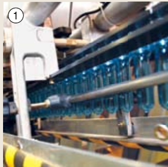
Entrée des préformes
