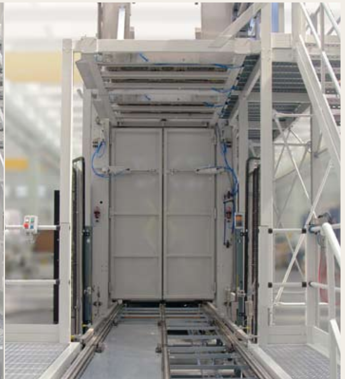
Elevación palet en el interior del cuerpo central
