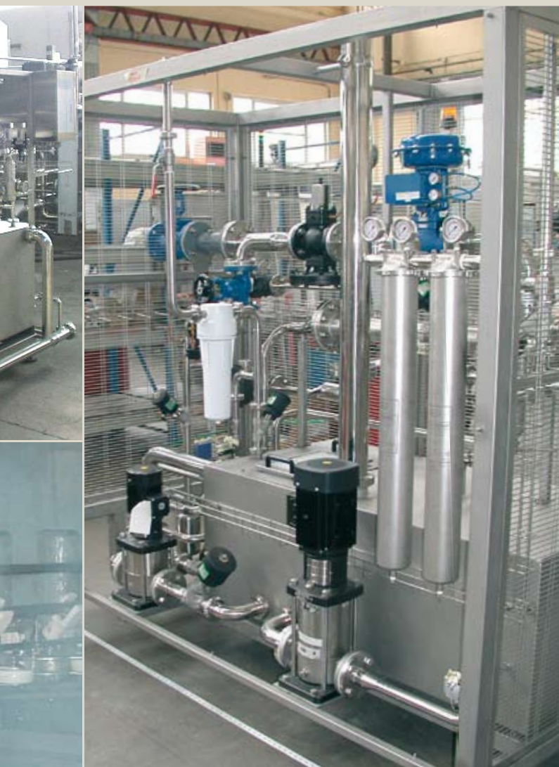
Unidad de preparación de agua caliente
