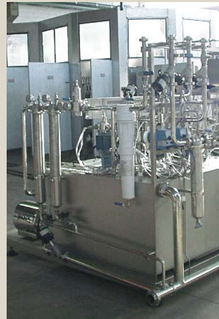
Unidad de preparación del cloro
