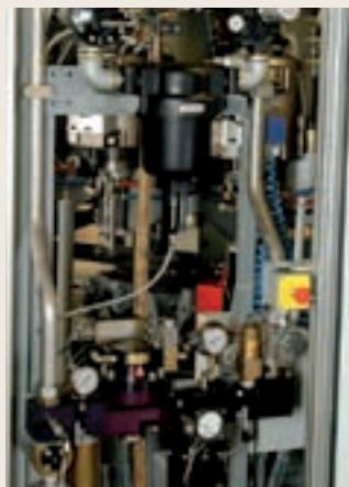
Las llegadas de agua y aire son perfectamente accesibles.
