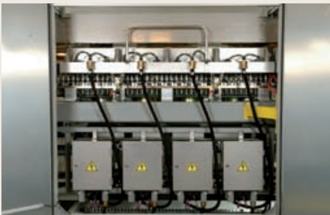
El desvío de las cajas eléctricas reduce el tamaño del tablero principal.
